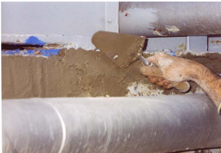
Dos momentos de la reparación llevada a cabo con el producto Q-2039 con herramientas de enlucido normales.
